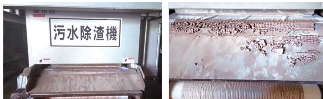
廢棄物減量改善：污水除渣
